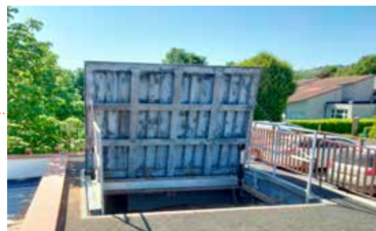
Trappe du silo de stockage
