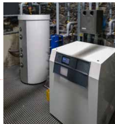
Pompe à chaleur
